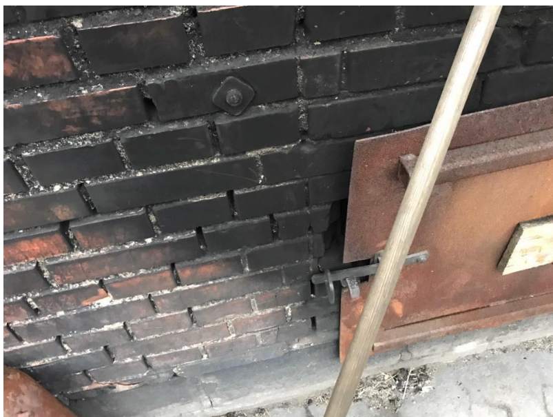
Foto 02: Skadede fuger som følge af brand og manglende vedligehold.
