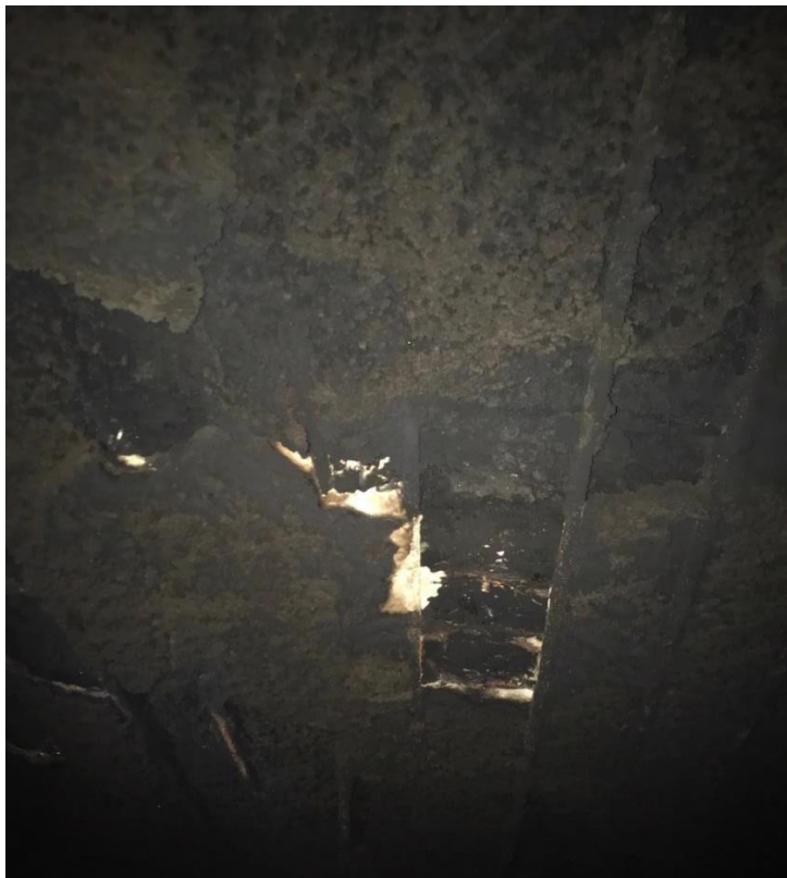
Foto 07: Blottede jern i dækundersiden og afsprængt beton
