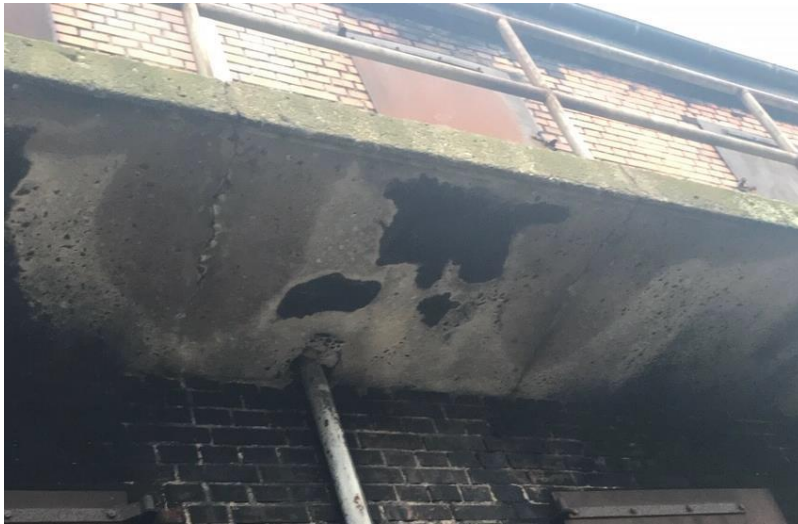
Foto 08: Svalegang med revner
