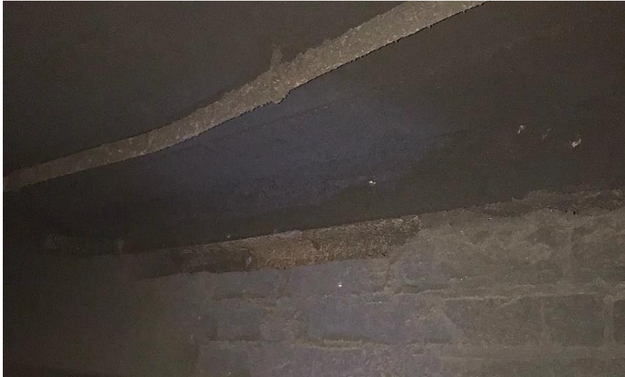
Foto 10: Langsgående stålbjælke uden brandbeskyttelse
