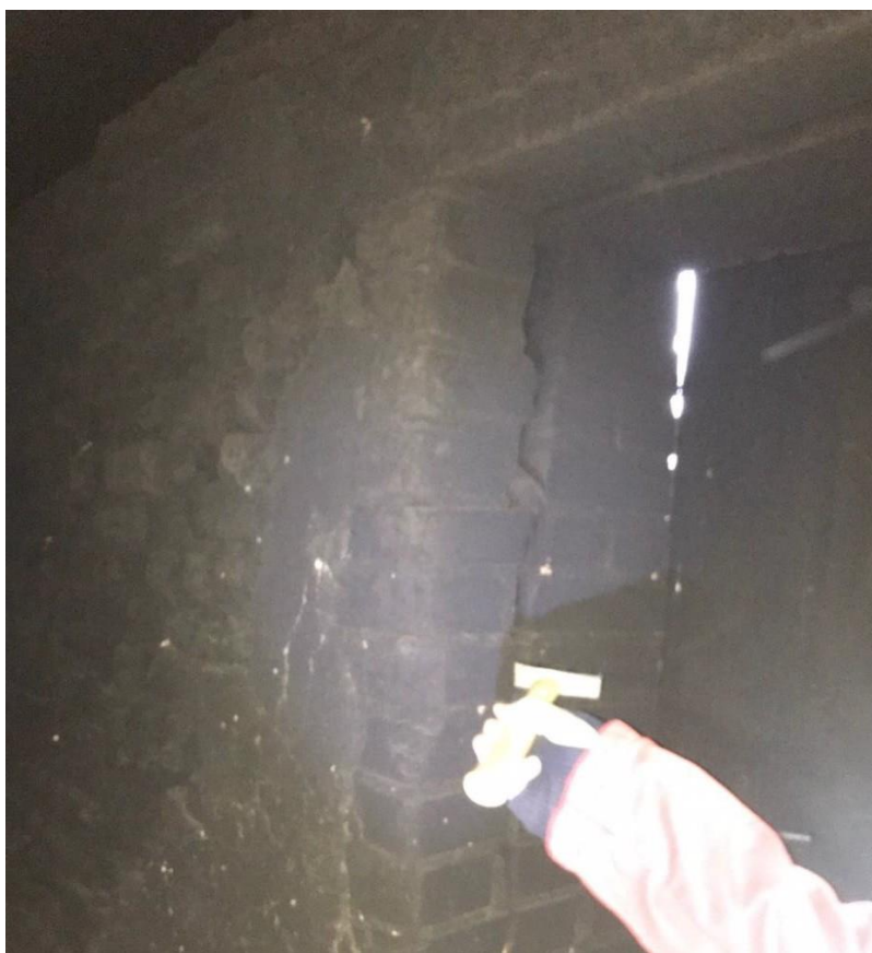
Foto 04: Teglmur på 1 sal hvor der ikke er forbindelse mellem formur og bagmur.
