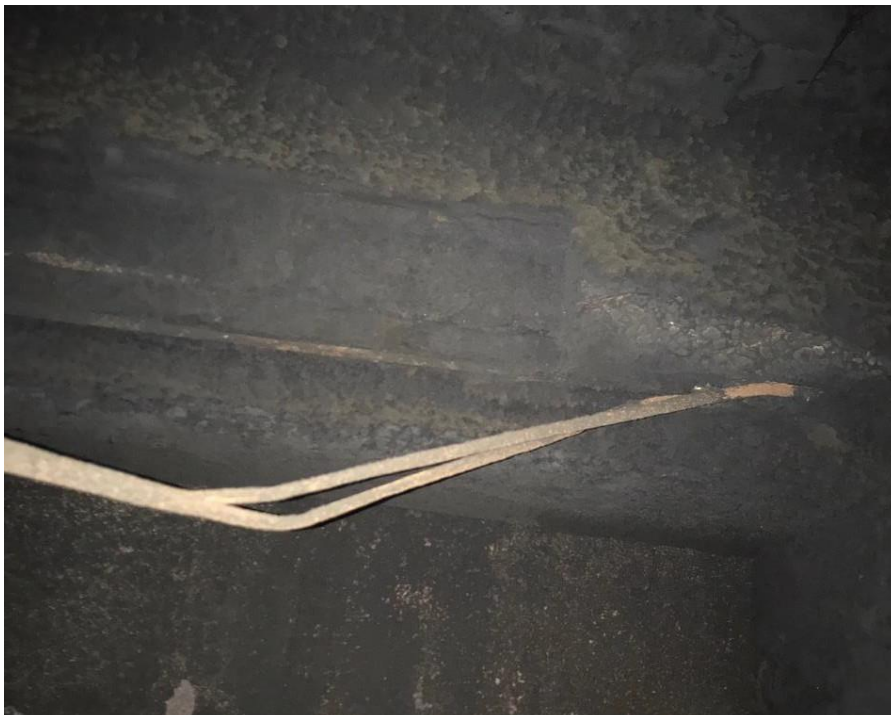
Foto 09: Betonbjælker med synlig armering.
