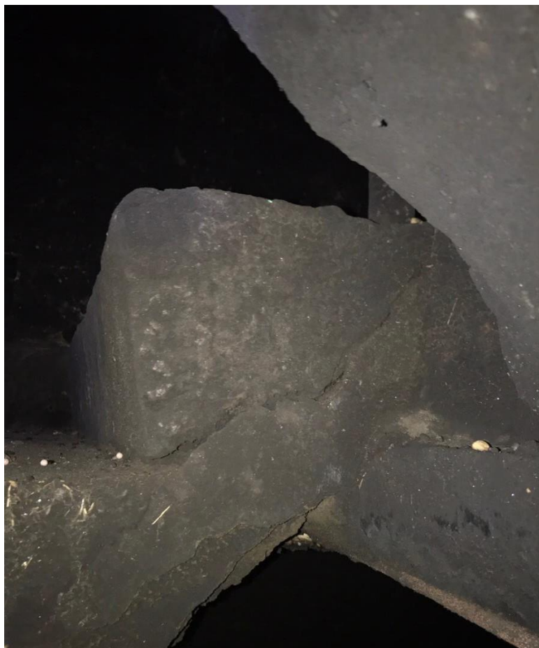
Foto 11: Revne i trappe
